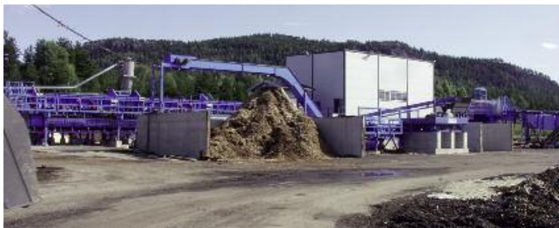
Det nye tømmerinntaket erstatter det opprinnelige fra 1974.
